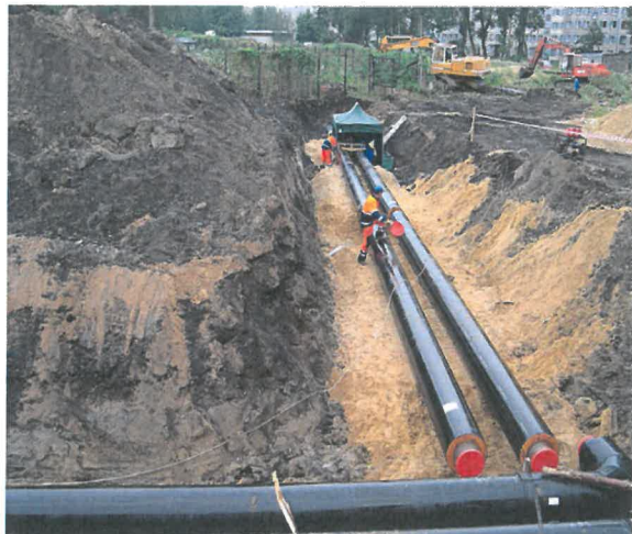
Fot. 2. Sieć ciepłownicza preizolowana.
