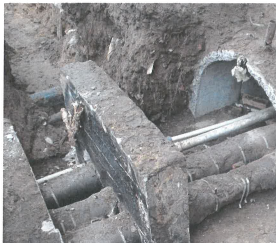
Fot. 3. Sieć ciepłownicza kanałowa
